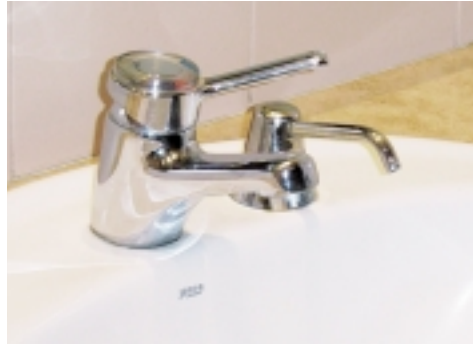
Elementos de fontanería instalados
