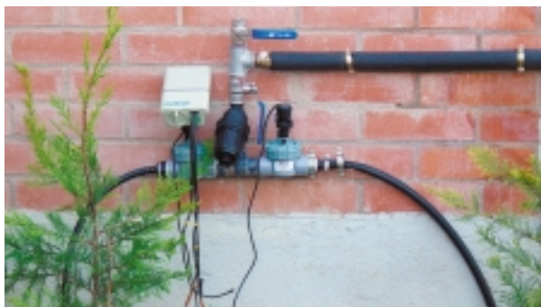
Detalle instalación de riego
