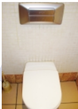
Detalle de lavabo e inodoro ahorradores de agua
