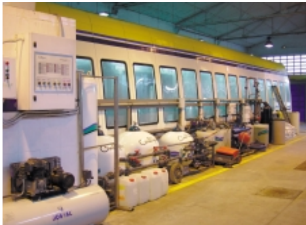
Instalación de reutilización de agua
